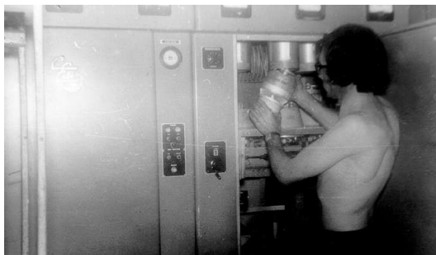
Ci-dessus, placement d'un tube final 4CX5000. Il y en avait 4 par émetteur. Modulation écran par 4 tubes 4-65A.
