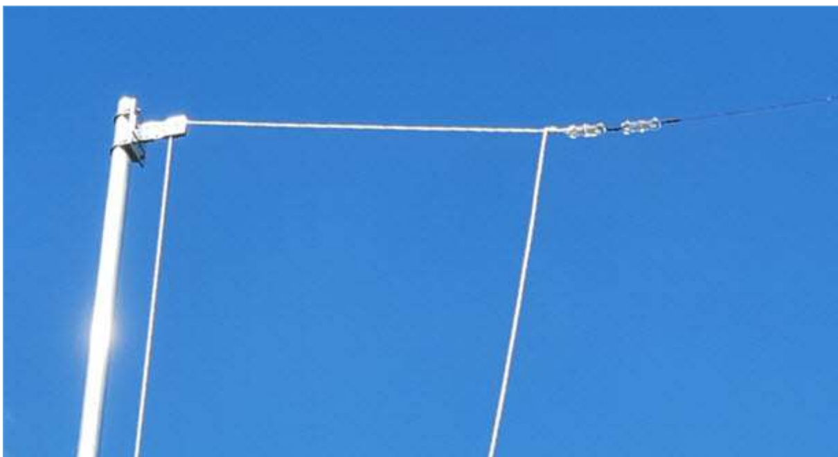
Fig. 84 : Vue de détail de l'arrimage de l'extrémité de l'antenne End-Fed avec deux isolateurs pyrex au niveau du mât situé à l'autre coin du jardin. Photo : ON4HNO.
