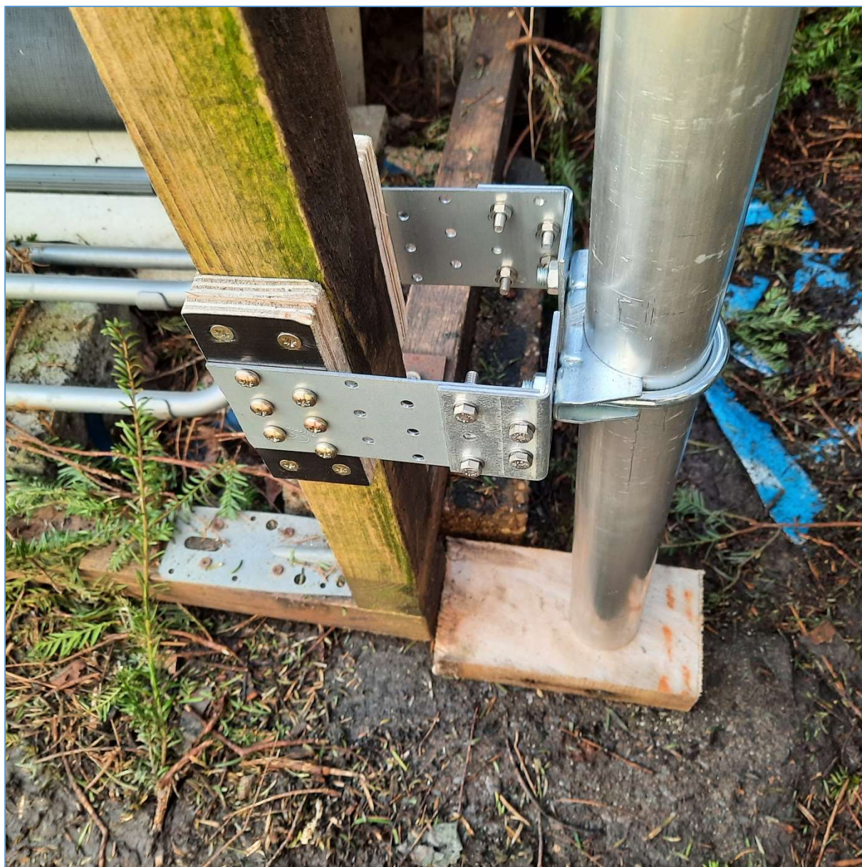
Fig. 5 : Détail d'arrimage à la base du tube alu sur un montant de la cabane. Photo : ON4HNO.
