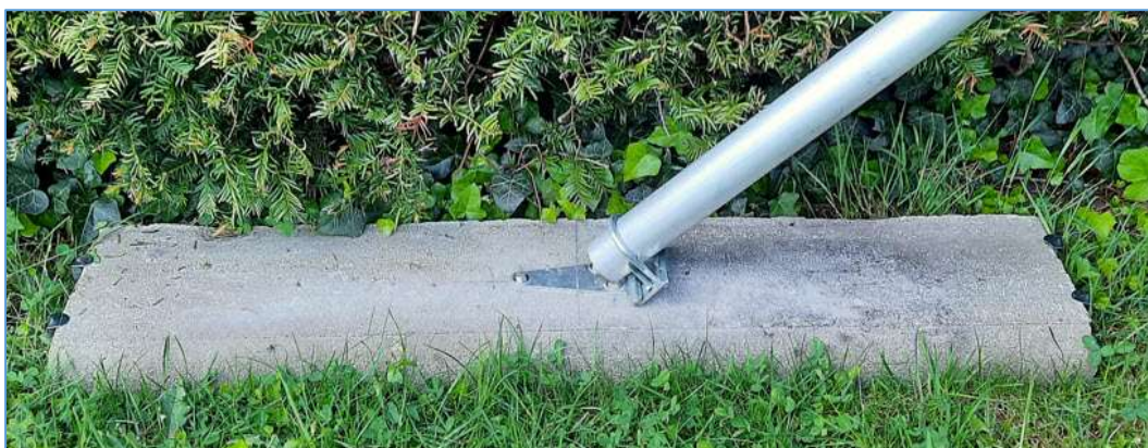
Fig. 16 : Détail de l'ancrage des jambes de force avec une articulation réalisée au moyen d'une penture et d'un collier « clamp ». Des grosses sardines de tente empêchent le glissement de la bordure en béton. Photo : ON4HNO.
