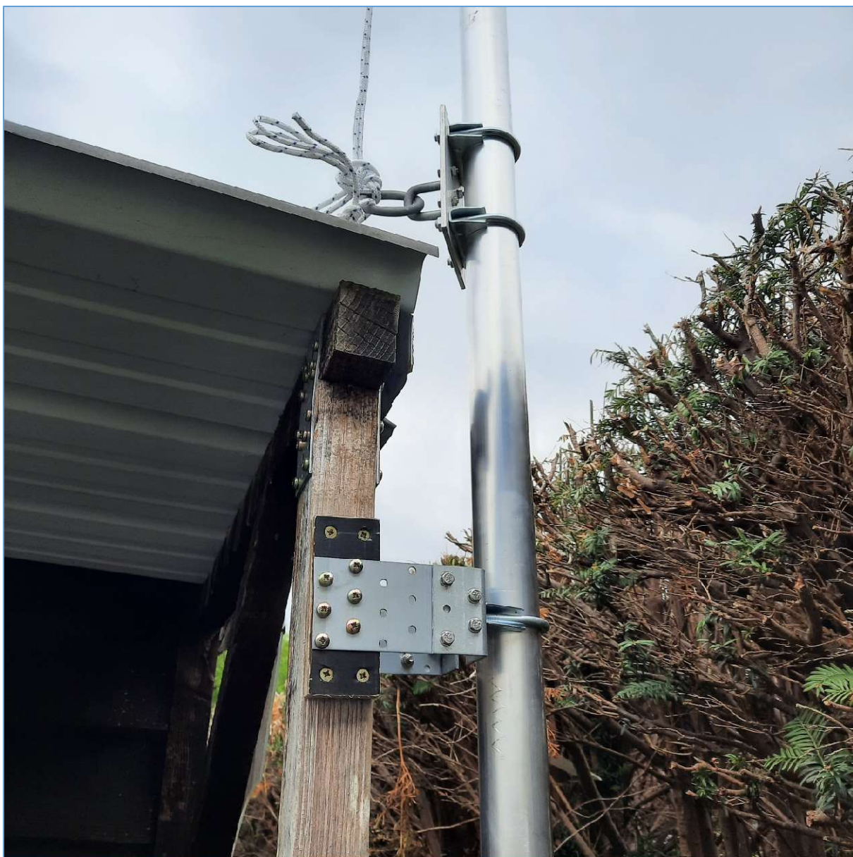
Fig. 6 : Détail d'arrimage du tube alu sur le dessus d'un montant de la cabane. Une plaque avec deux colliers « clamp » permet l'arrimage de la corde allant vers la poulie située au sommet du tube. Photo : ON4HNO.
