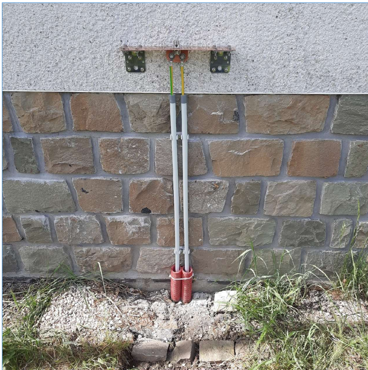
Fig. 31 : Vue d'ensemble du raccordement de la prise de terre HF. Photo : ON4HNO.
