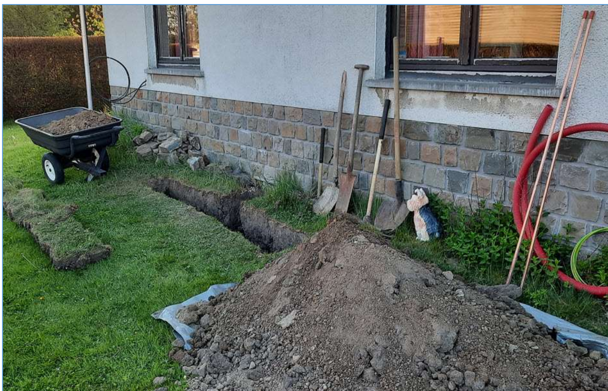
Fig. 27 : Travaux de terrassement pour l'installation d'une prise de terre HF. Photo : ON4HNO.
