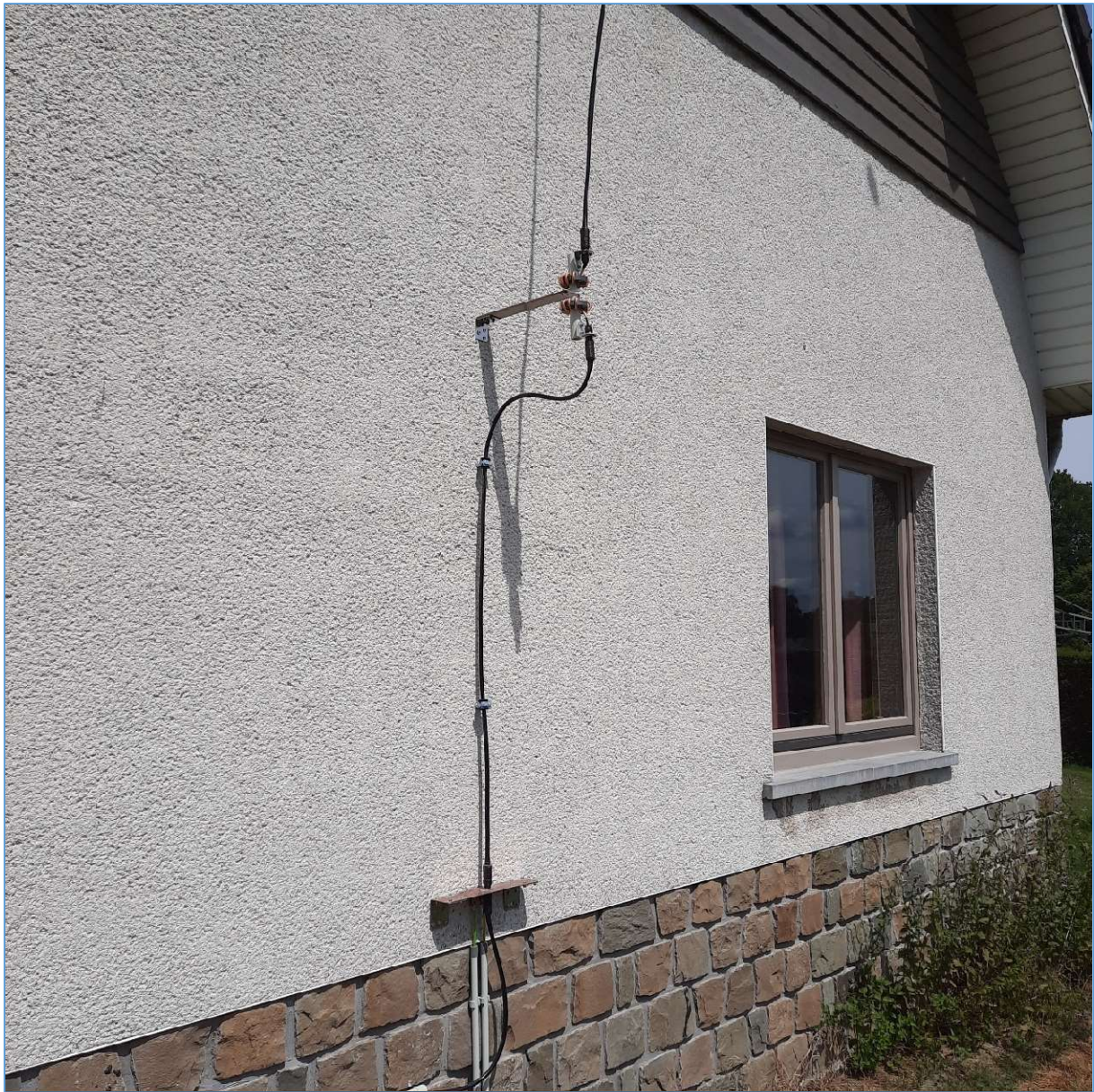
Fig. 81 : Vue de détail du Common Mode Choke Unun, et de la mise à la terre du feeder. Photo : ON4HNO.
